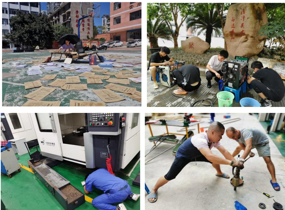
图 9-4 修复档案材料与教学设施设备
